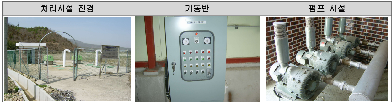
[그림 9.3-1] 소규모하수처리시설 주요시설 전경
